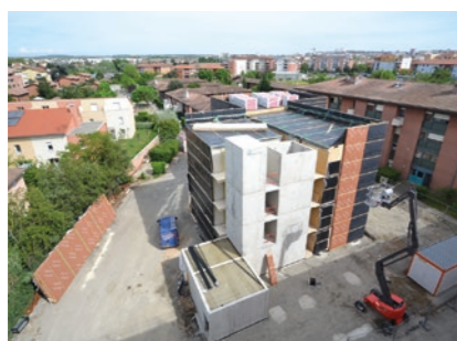
► Gain de temps et efficacité : l'isolation extérieure a été posée par panneaux préfabriqués de 12 m de haut par trois compagnons.
